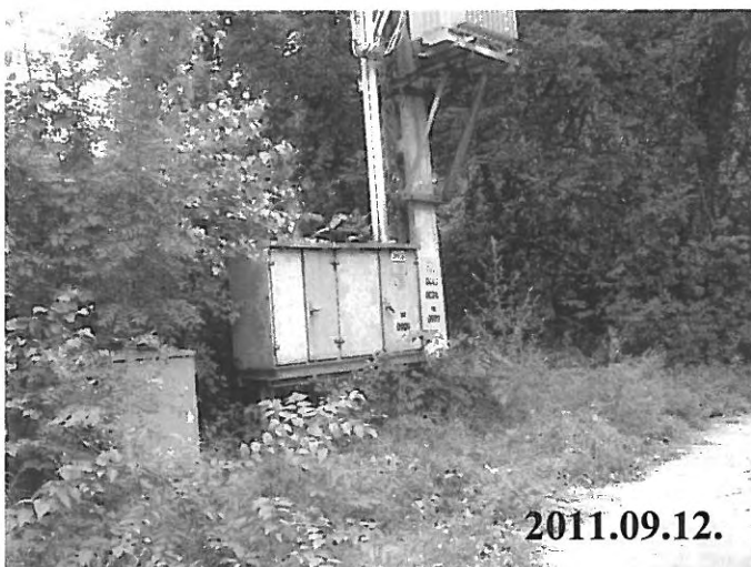
141. számú kép: kórház trafóállomása
