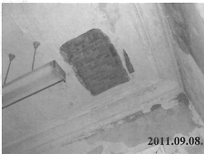
27. számú kép: I. jelű kastélyépület földszinti acélgerendás porosz süveg károsodott
