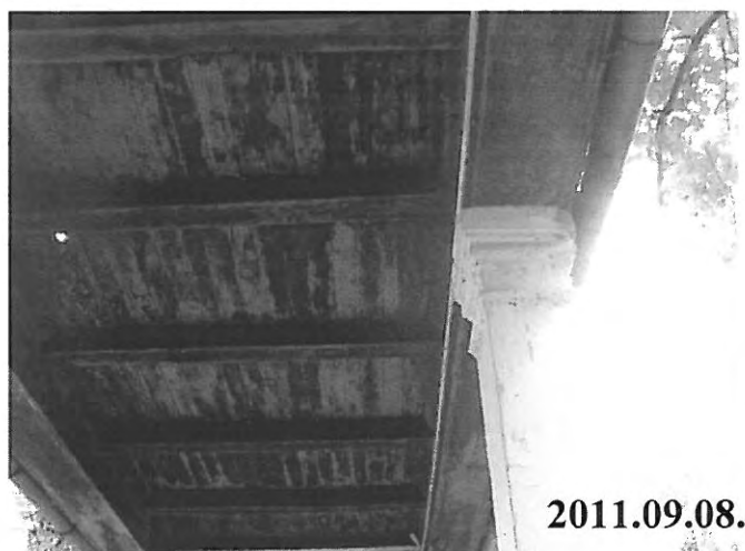
13. számú kép: fedett átjáró pórfödeme károsodott
