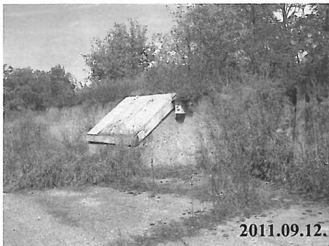
135. számú kép: XIII. jelű épület: használaton kívüli olajtartály
