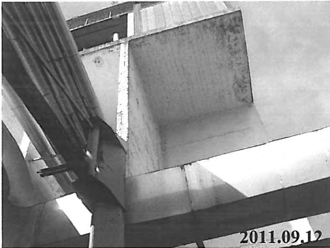
137. számú kép: XV. jelű épület vasbeton műtárgy ráhelyezett kéménnyel, használhatatlan állapotban
