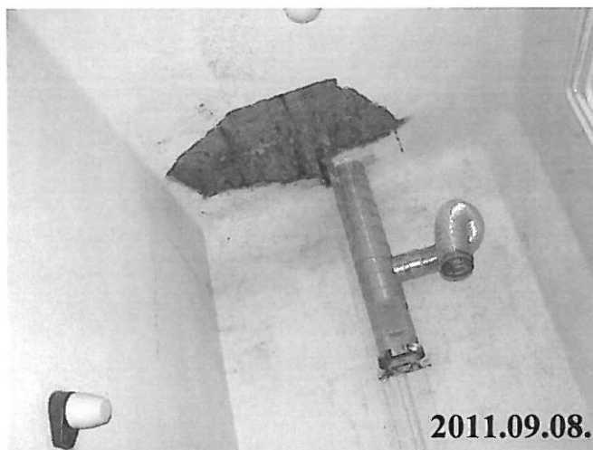
80.sz.kép:II.jelű épület szolgálati lakás 2.sz.lakás fürdőszoba mennyezetkárosodás
