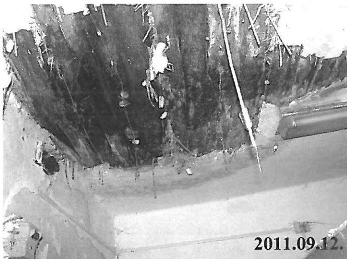
119. számú kép: X. jelű épület: raktár, több funkciója volt, mennyezeti károsodás
