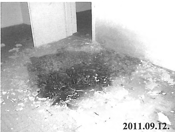
93. számú kép: II. jelű épület szolgálati lakás 4. számú lakás – károsodott szoba
