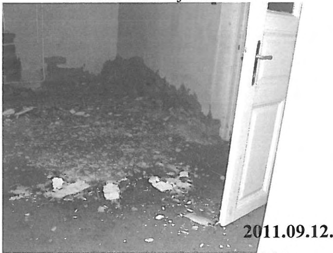
97. számú kép: II. jelű épület szolgálati lakás 5. számú lakás – károsodott szoba
