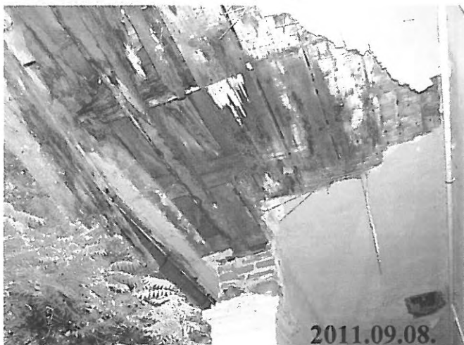
85.sz.kép:II.jelű épület szolgálati lakás tornácon lévő fa áthidaló és tetőszerkezet károsodása
