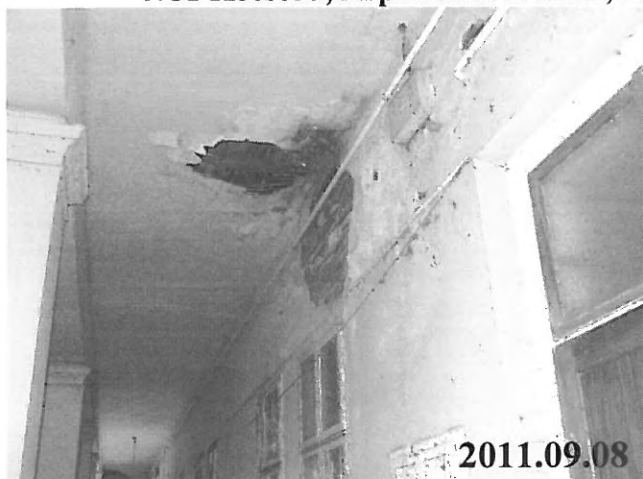
71. sz. kép: II. jelű épület szolgálati lakások tornácon lévő mennyezeti károsodások
