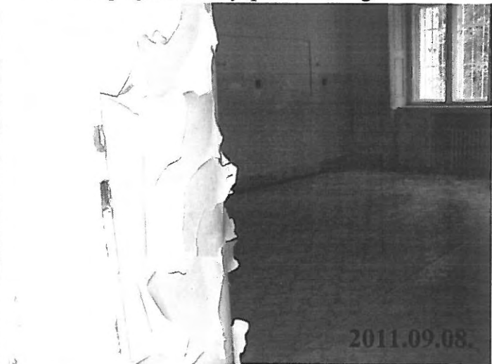
20. számú kép: I. jelű kastélyépület földszinti kórterem, avult, károsodott
