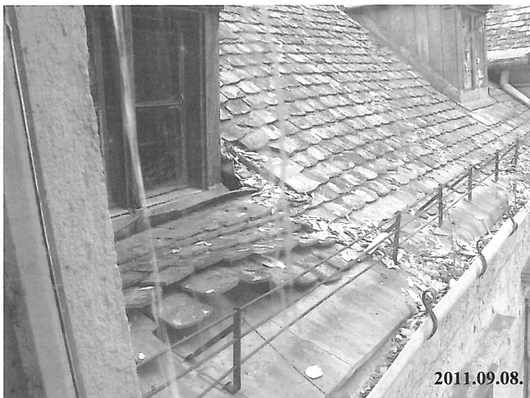
10. sz. kép: I. jelű kastélyépület I. emeletéről készített fotó, tetőhéjazat károsodás
