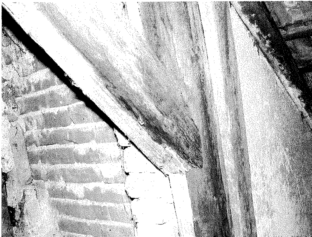
5. számú kép: padlástér – sérült faszerkezetek, gombák által okozott korhadás
