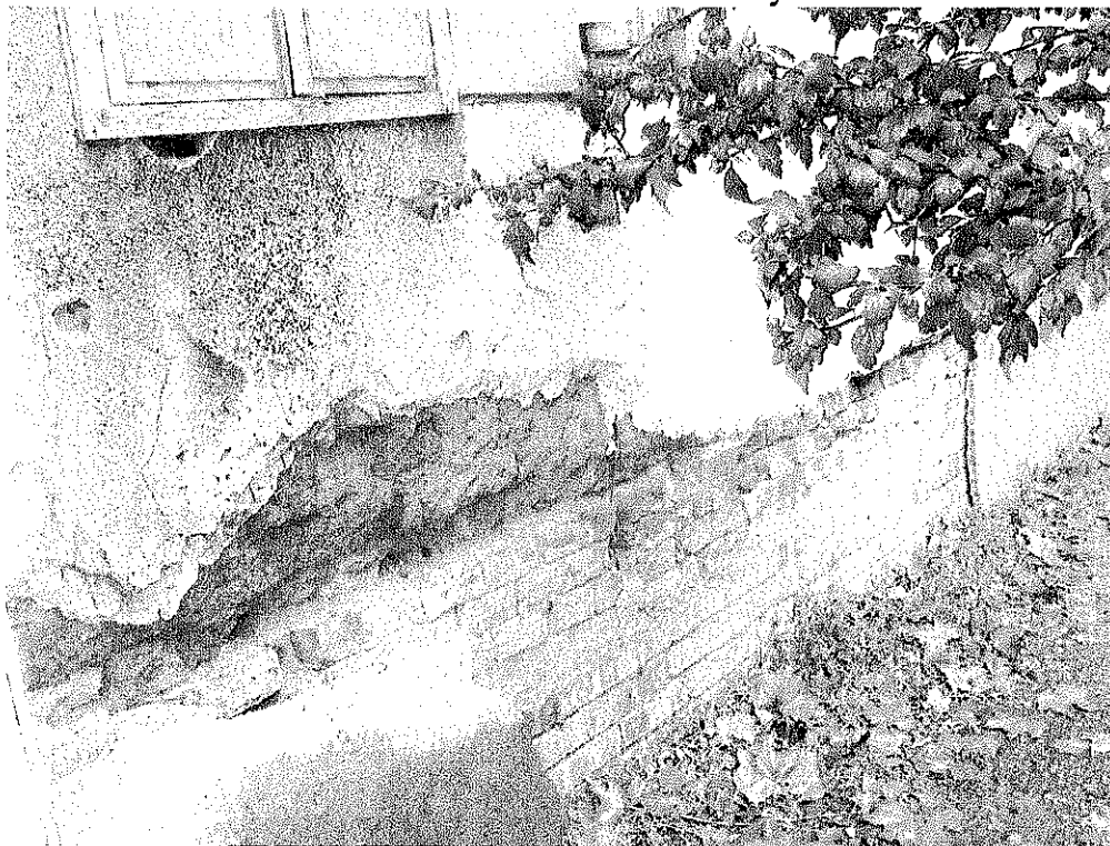
14. sz. kép: I. jelű lakrész – bejárat, a téglalábazat és vályogfal a szigetelés hiánya miatt károsodott, avult
