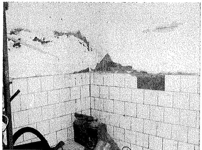
24. sz. kép: I. jelű lakrész – kamra, avult, károsodott
