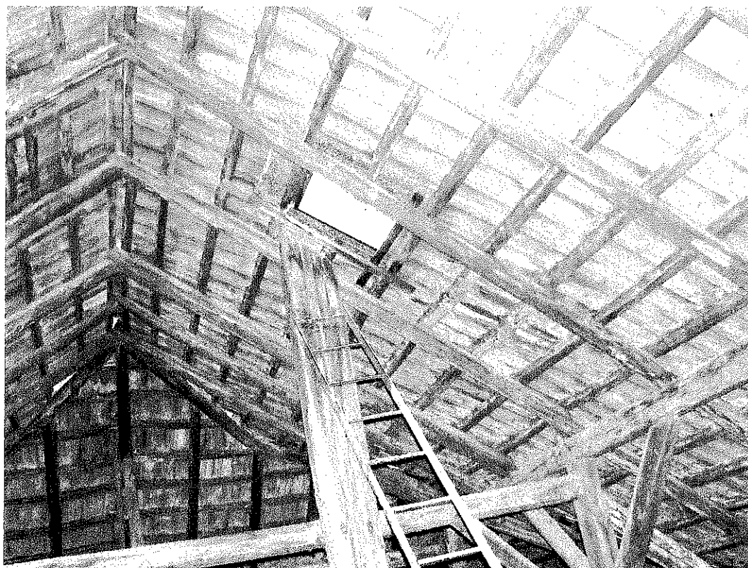
8. számú kép: padlástér – károsodott szaruzat, lécezés, szú ette, cseréphiányos Nyíregyháza, 2009. október 15.
