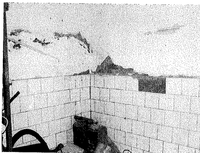
24. sz. kép: I. jelű lakrész – kamra, avult, károsodott
