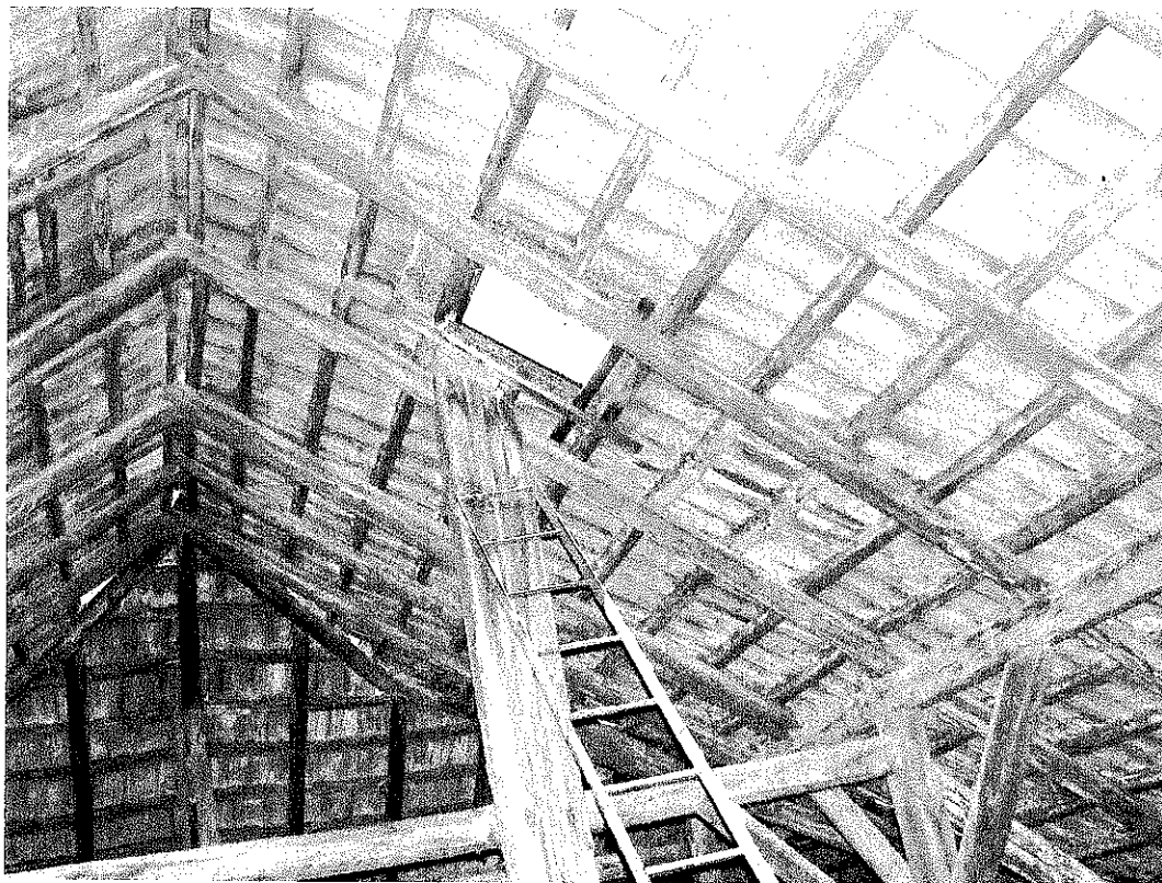
8. számú kép: padlástér – károsodott szaruzat, lécezés, szú ette, cseréphiányos Nyíregyháza, 2009. október 15.
