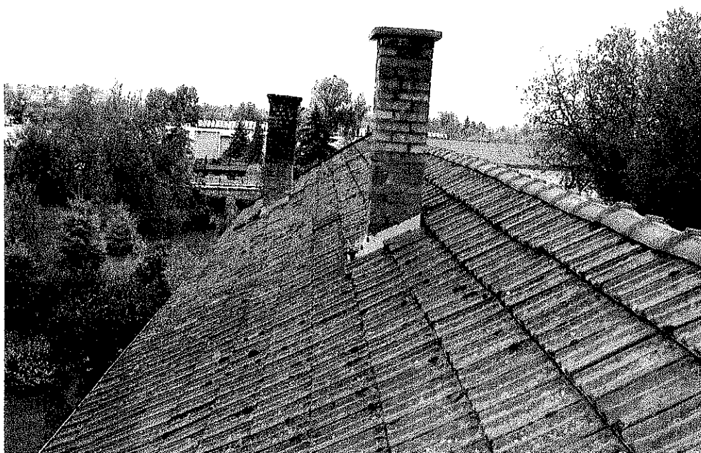
4. számú kép: az oldalhatári tetőhéjazat károsodott, több helyen behajlott szaruzat és lécezés tapasztalható
